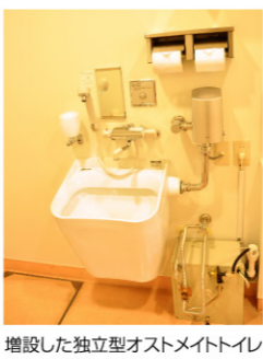
増設した独立型オストメイトトイレ
